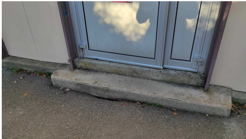
Formation de trous sous la porte d'accès de l'école
