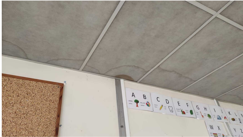
Traces d'humidité au plafond d'une salle de classe
