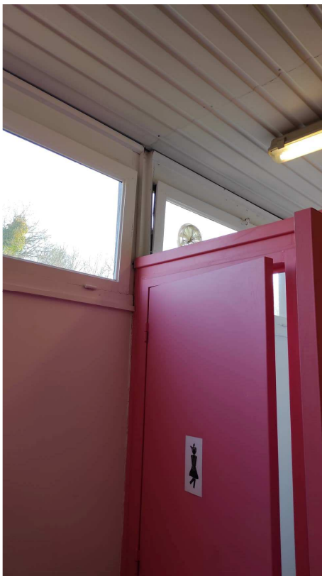
Fenêtre cassée dans les sanitaires
